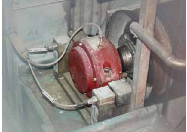
Bahnspannungsmessung in der Trockenpartie
